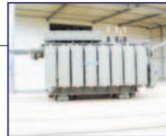
30 MVA 110/11,5 kV ONAN
