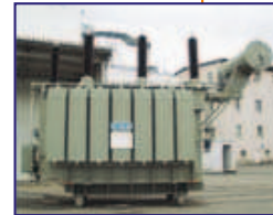
40 MVA 150/10,5 kV ONAN
